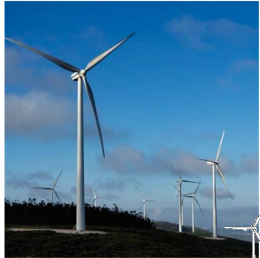
Figura 1: Campo de turbinas eólicas de eje horizontal generadoras de electricidad. Fuente: Small wind turbines
